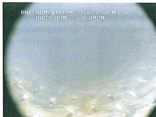
Turbidité généralisée avec venues de particules de carie au droit de certaines fentes oblongues
